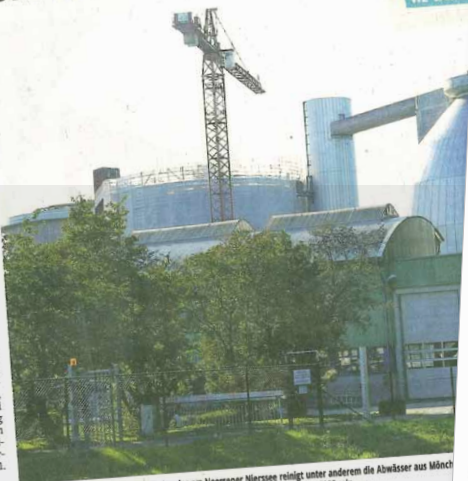
Das Neuwirker Klärwerk des Niersverbandes am Neirsener Nierssee reinigt unter anderem die Abwässer aus Mönchstein. Bis zu 50 Millionen Euro sollen es bis 2025 sein.
